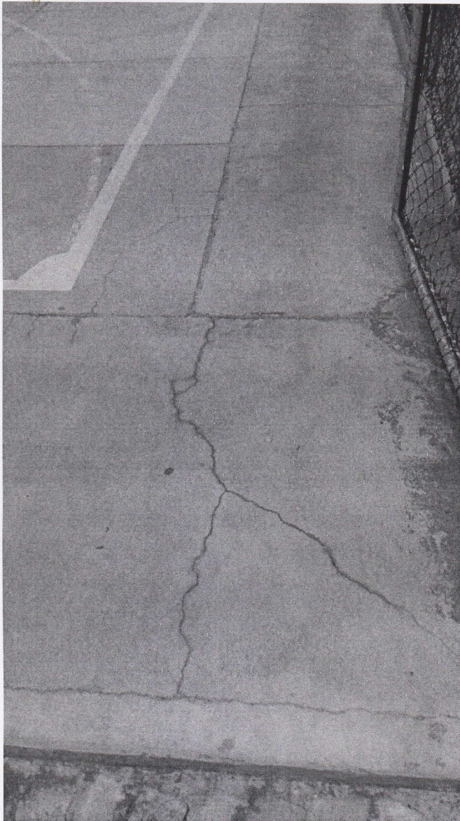
Foto 03 – Piso com rachaduras
