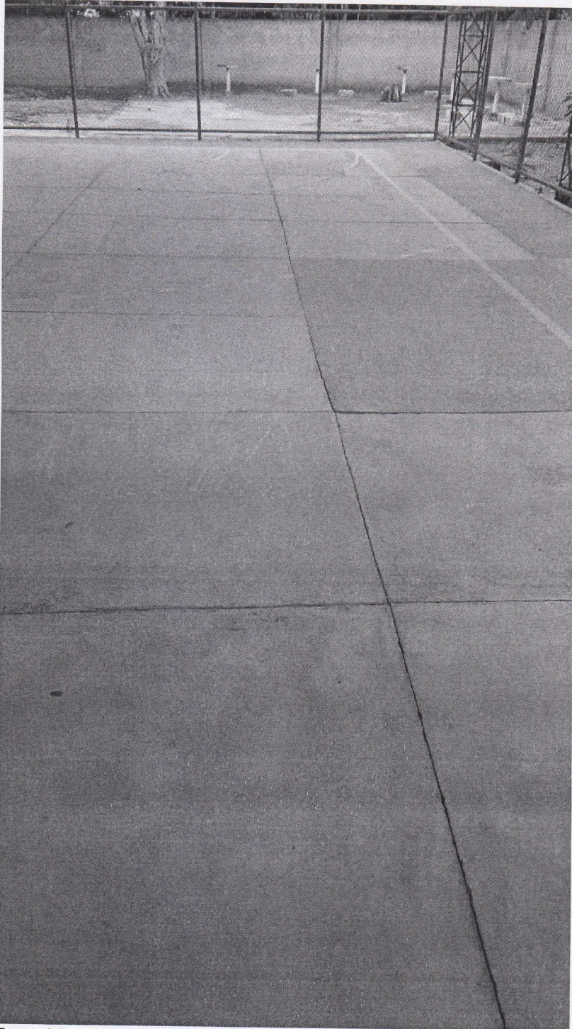
Foto 01 - Piso irregular, com ressaltos
