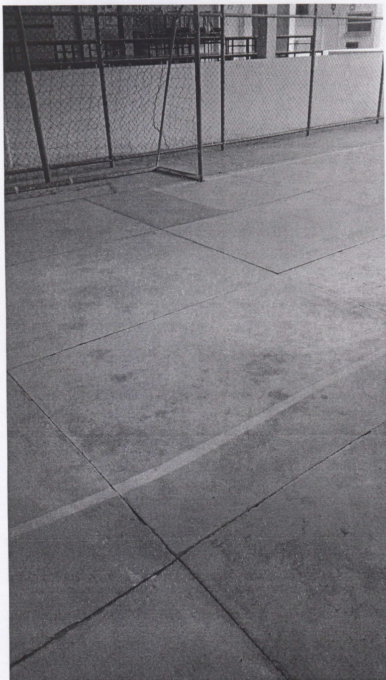
Foto 02 – Piso com ressaltos e alambrado danificado
