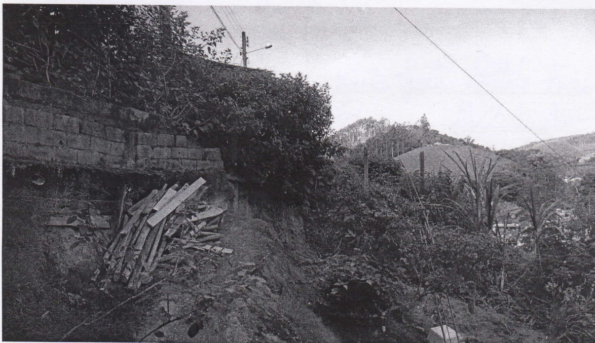
Foto 04 – Risco de desmoronamento de área de terra (necessidade de muro de arrimo)
