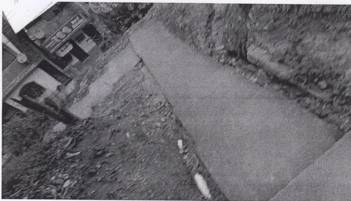
Foto 03 – Escadaria sem sistema de drenagem (água entra nas residências abaixo)
