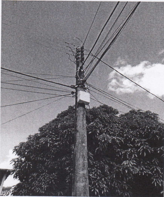
Foto 1: vista do poste sem o braço de luz.
