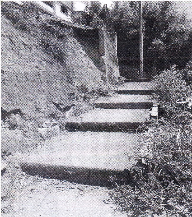
Imagem 03 - Escadaria sem corrimãos e risco de desmoronamento
