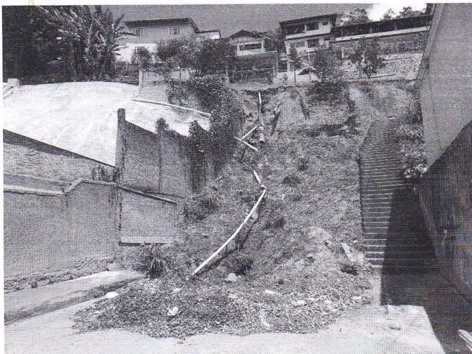
Imagem 01 - Vista frontal do desmoronamento do muro
