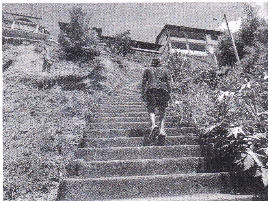
Imagem 02 - Escadaria sem corrimãos
