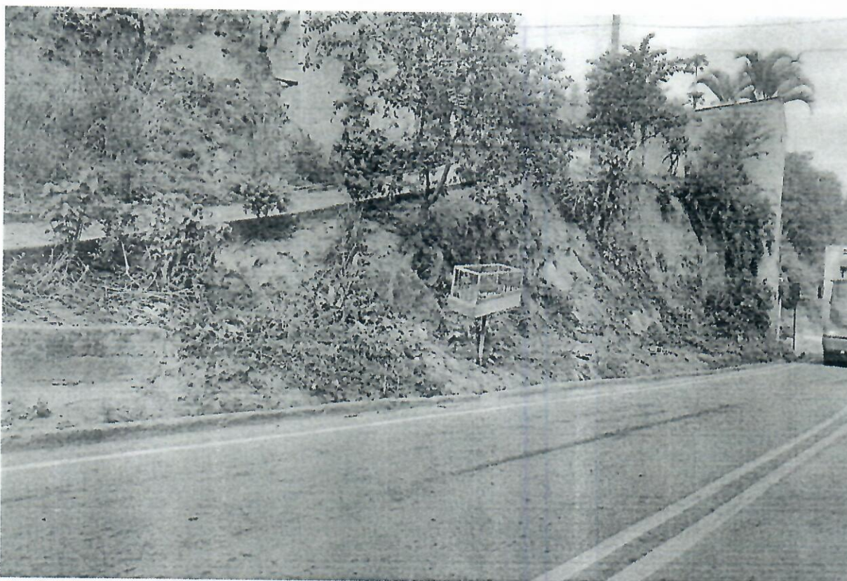
1 – Trecho da Rua São Lourenço que necessita de melhorias
