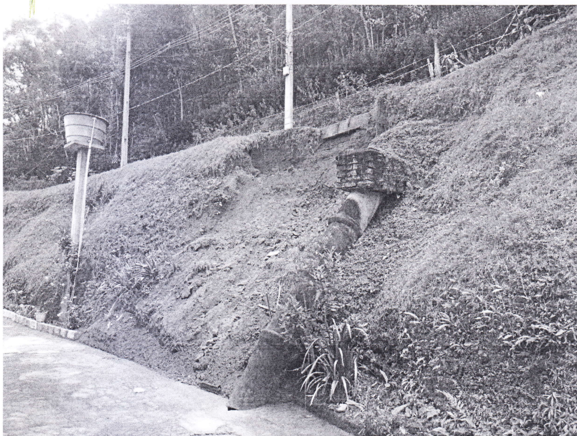
Foto 1 – deslizamento de encosta na rua Maximiliano Carreta
