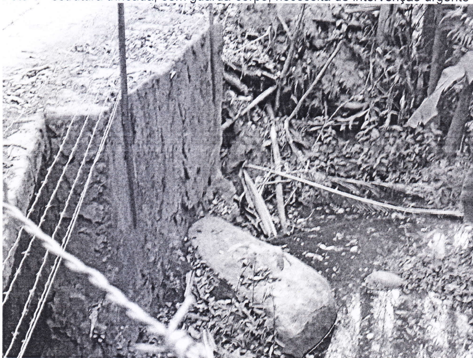
Foto 2 - local onde o ônibus escolar caiu, ficando pendurado, risco aos alunos e ao motorista.
