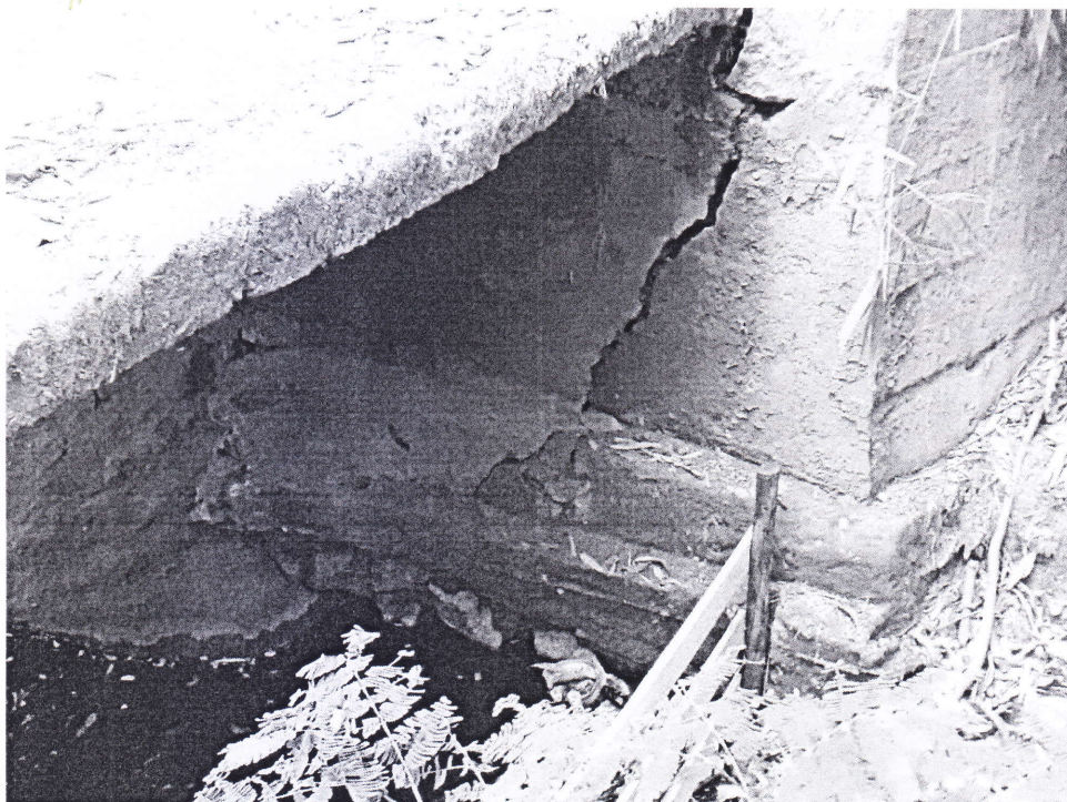
Foto 1 - estrutura trincada, sem guarda-corpo, necessita de intervenção urgente
