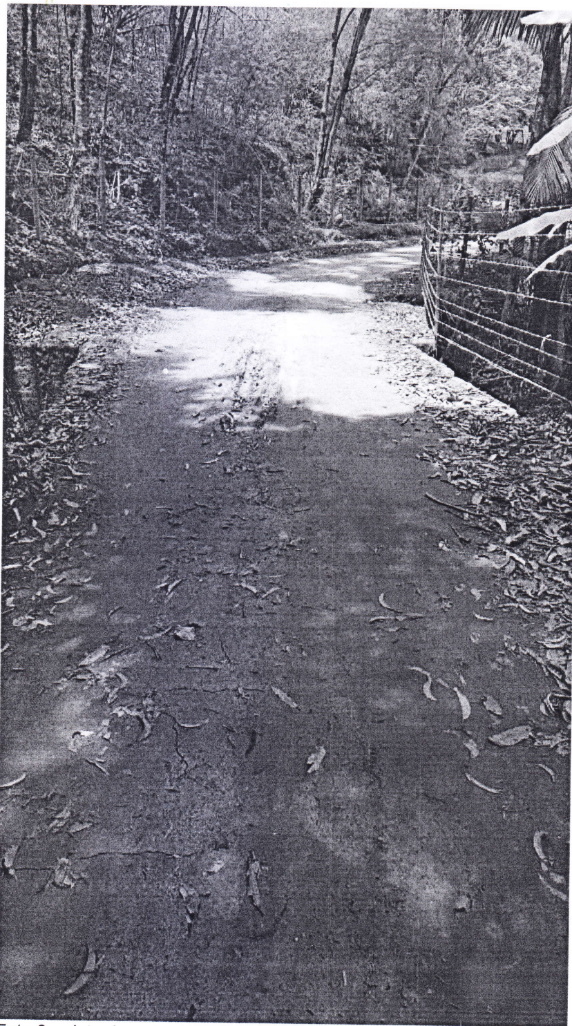
Foto 3 - vista de outro ângulo - ponte sem guarda-corpo nas laterais
