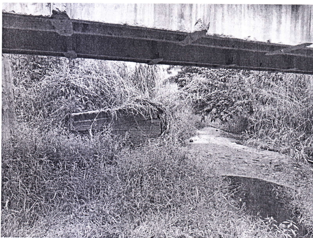
Foto 2 – vista dos restos de alvenaria da ponte antiga que obstruem o fluxo d'água no período chuvoso
