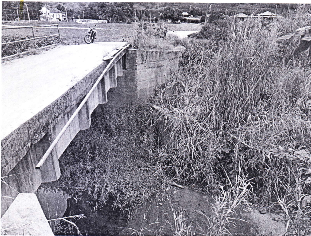
Foto 1 – vista da estrutura da ponte sem o guarda-corpo em um dos lados (risco aos usuários)
