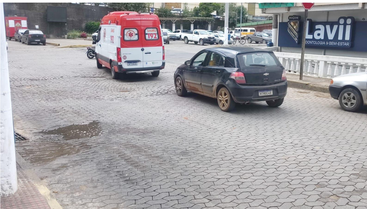
1. Afundamento do leito da via na Avenida Angelo Pretti, próximo a Farmácia Inova
