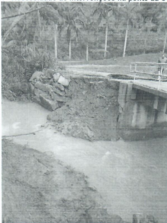
2 - Vista da cabeceira da ponte cedendo.
