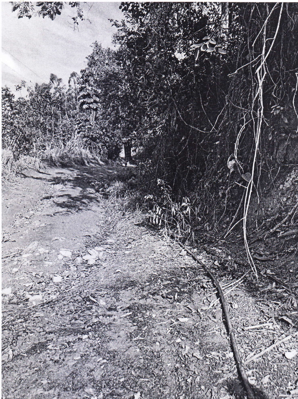
Foto 1 - situação atual dos canos de água (exemplo de um deles vazando)
