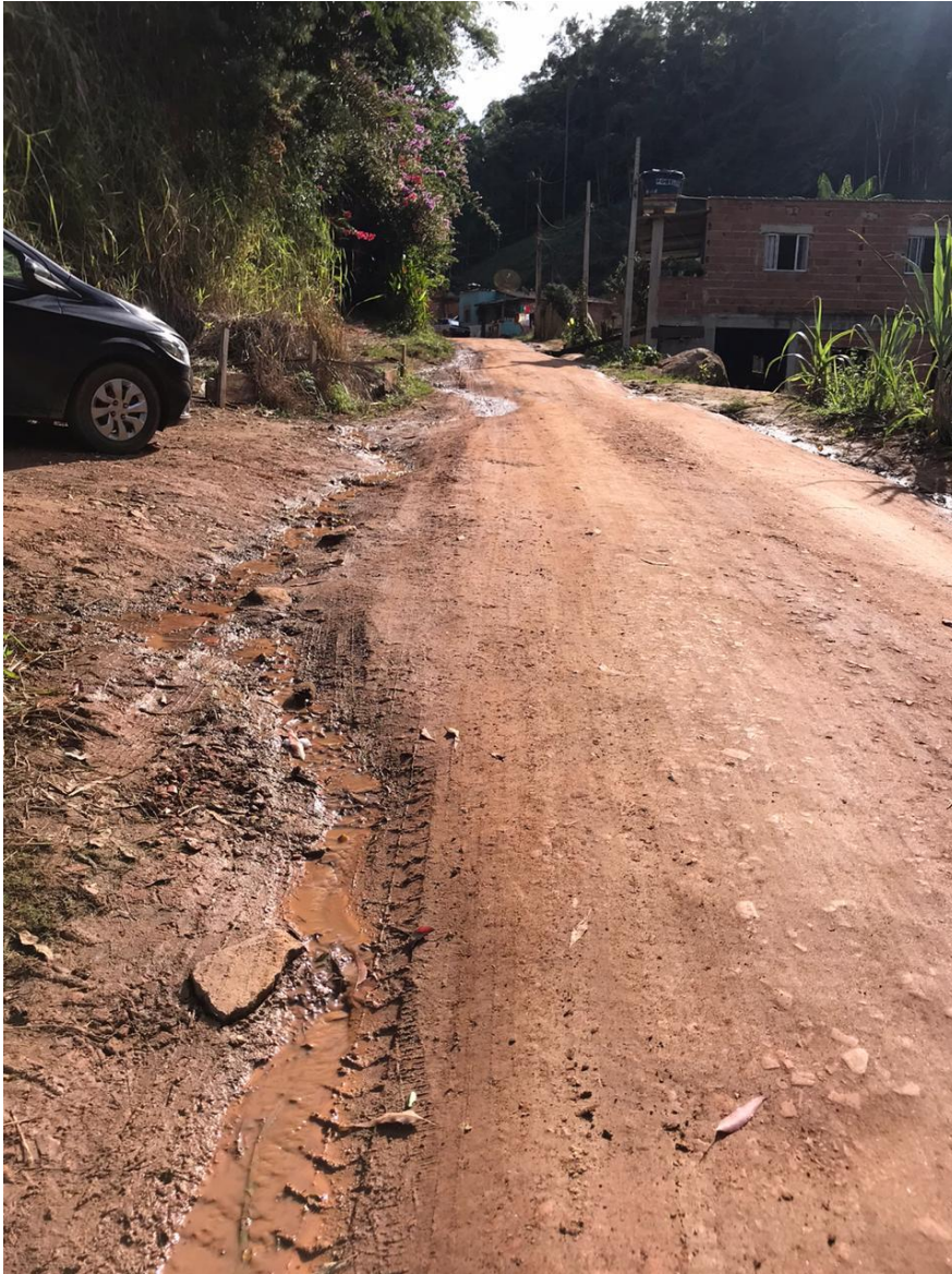
Foto 1 - situação da estrada vicinal onde precisa ser instalada a “boca de lobo”
