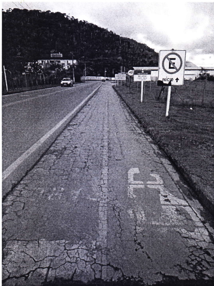
3. necessidade de manutenção/pintura/limpeza
