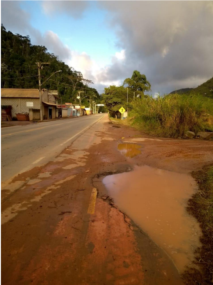
2. local que necessita de recuperação do pavimento
