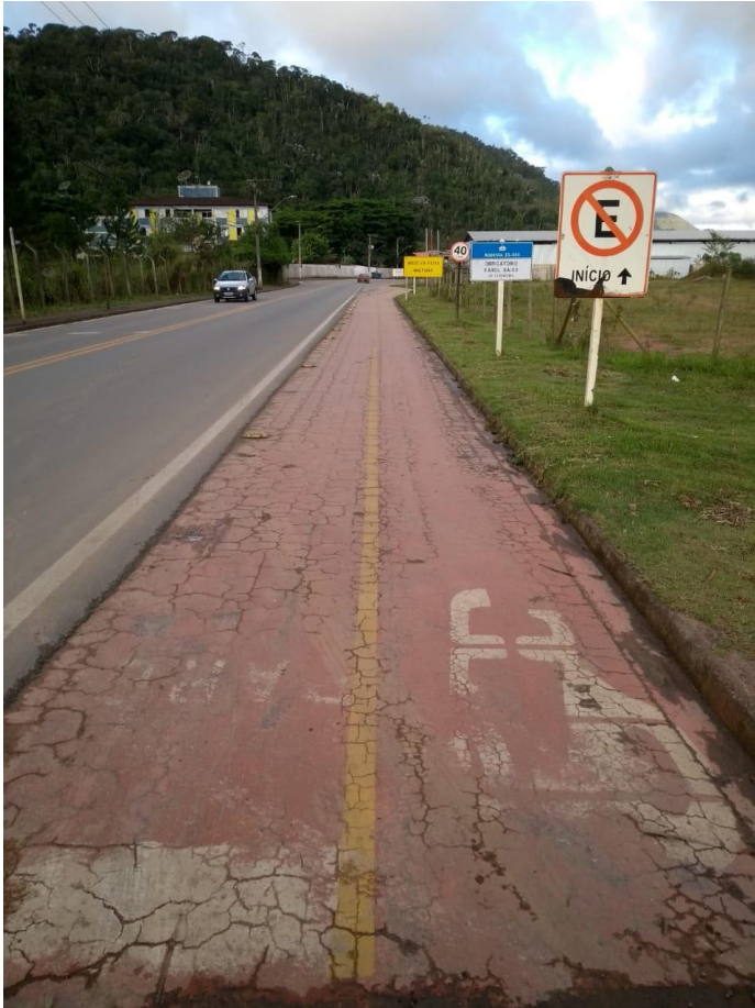
3. necessidade de manutenção/pintura/limpeza
