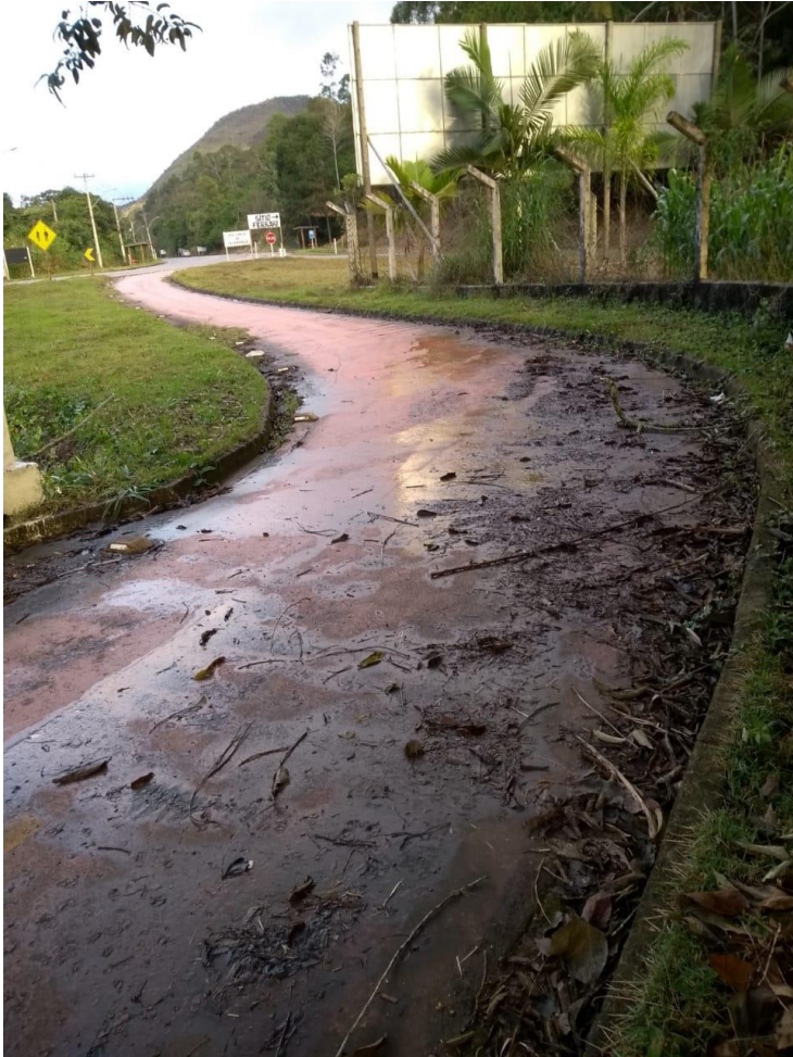
1. vista de trecho escorregadio da faixa multiuso
