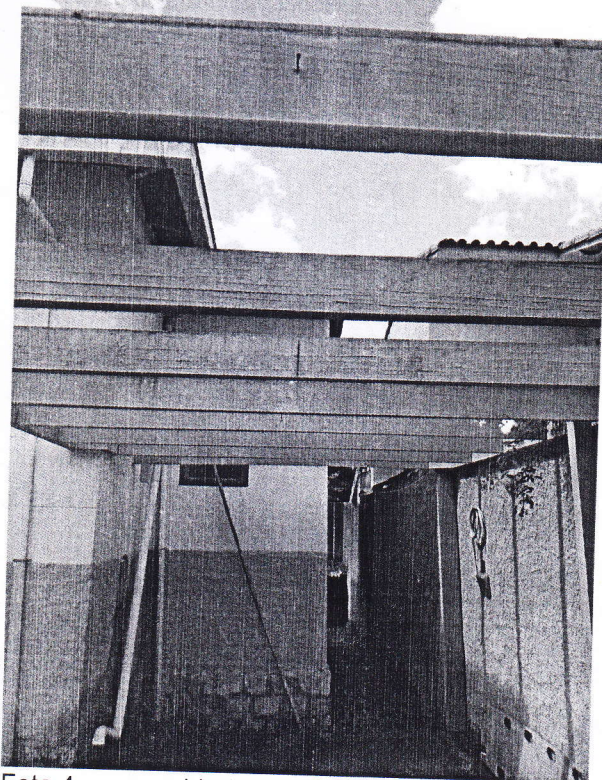
Foto 4 - necessidade de manutenção externa
