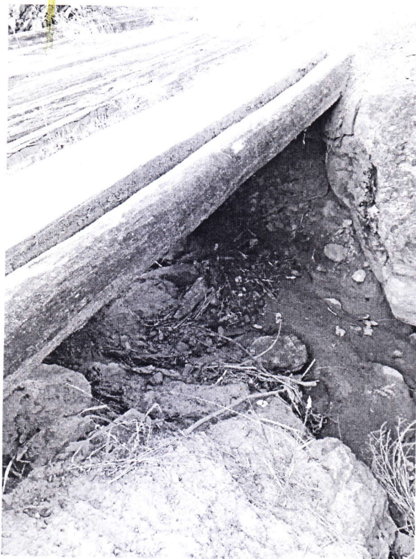
Foto 3 – a estrutura está cedendo em direção ao rio
