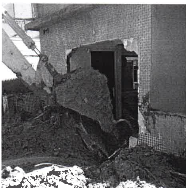
3 - imagens do desmoronamento, quando houve danos a residências situadas na rua Primeiro Centenário, sendo que, inclusive, houve deslocamento de um caixão que desceu até a porta da casa de um morador
