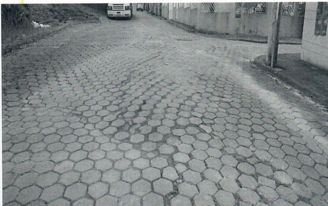
3. Desnívelamento do pavimento, com bloquetes soltos
