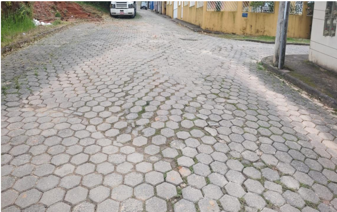
3. Desnívelamento do pavimento, com bloquetes soltos
