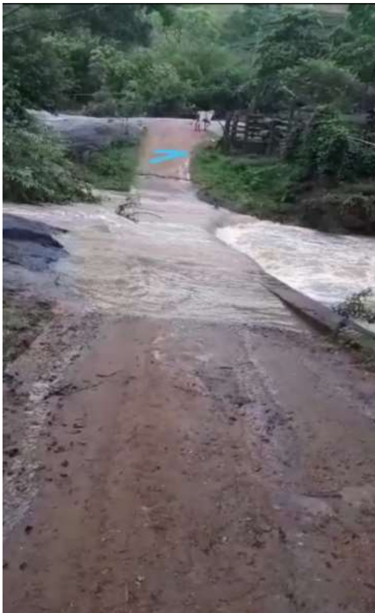
1 - situação da ponte na altura da propriedade do Sr. Pedro Bridi.
