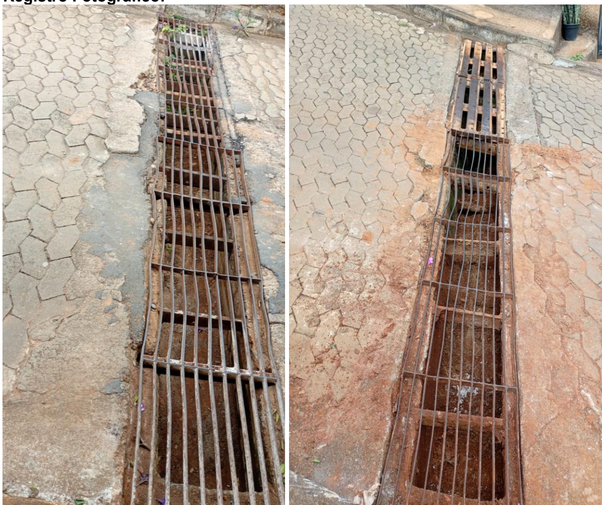
1. Situação das grelhas localizadas na Rua da CESAN, em Santo Antônio do Canaã.
