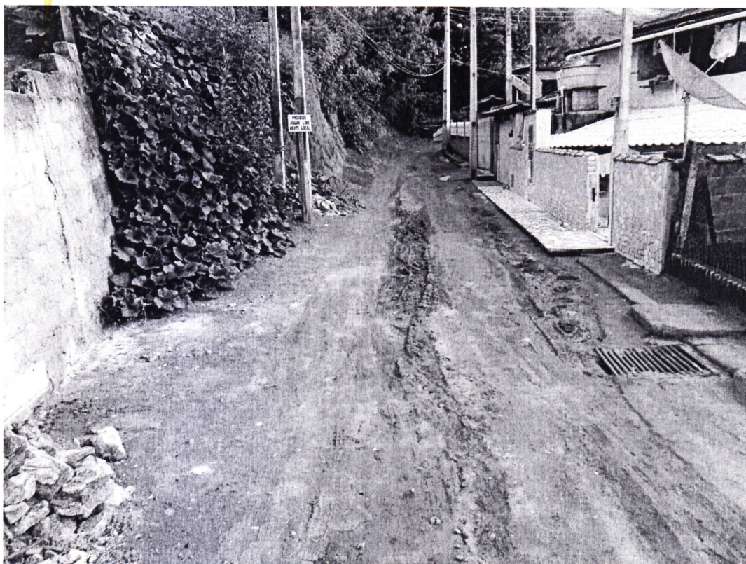
Foto 1 - vista da rua Olívio Cozzer - local de acúmulo de lama (pavimentação)
