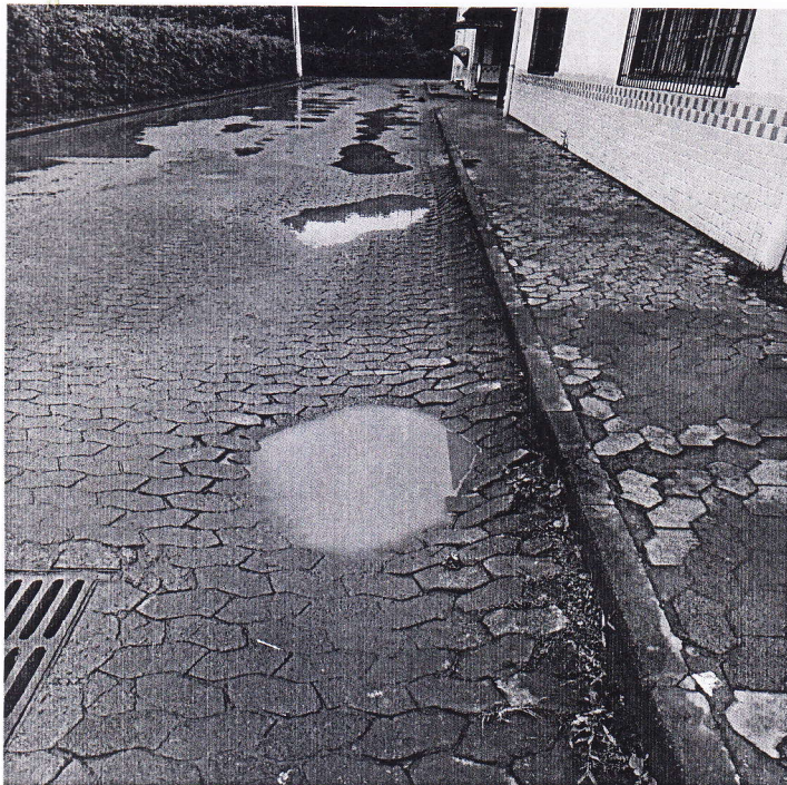
Foto 03 - Várias poças d'água se formam devido a situação
