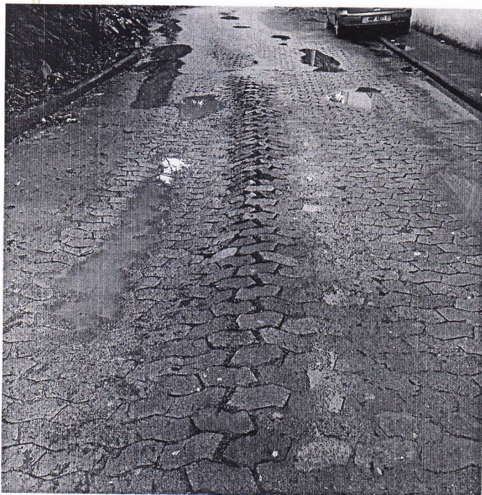
Foto 01 - Vista do pavimento que cedeu no leito da via
