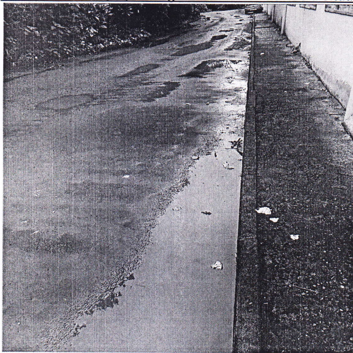
Foto 04 - Além das poças d'água a via está irregular, prejudicando o fluxo
