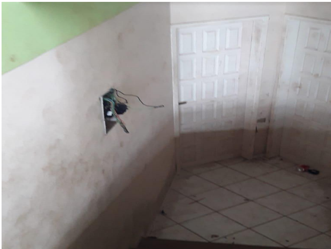
Foto 07 – Parte elétrica expostas provocando riscos iminentes
