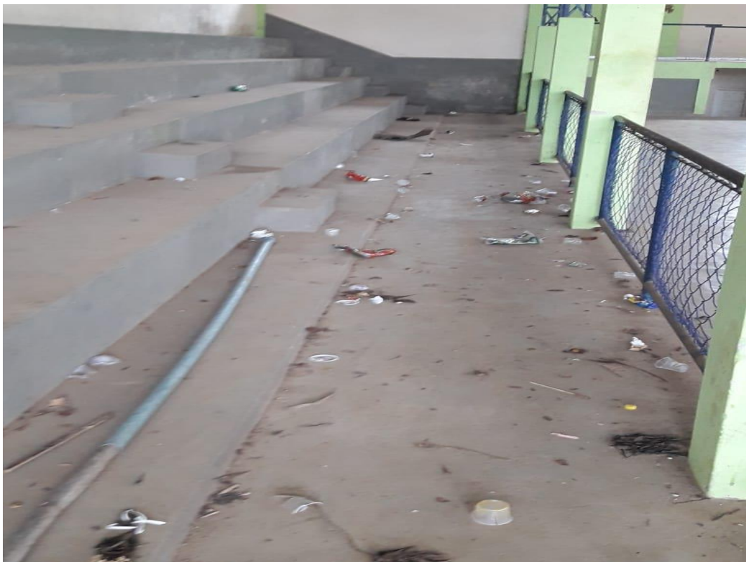
Foto 09 - Instalações insalubres e sem a devida conservação
