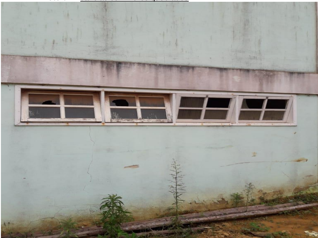
Foto 02 – Janelas com vidros sempre abertos e agora quebrados
