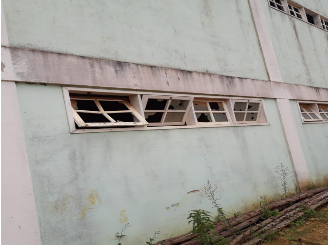
Foto 03 – Janelas com vidros sempre abertos e agora quebrados
