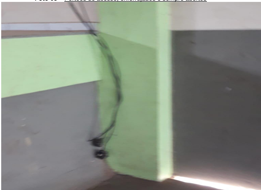
Foto 06 - Parte elétrica expostas provocando riscos iminentes
