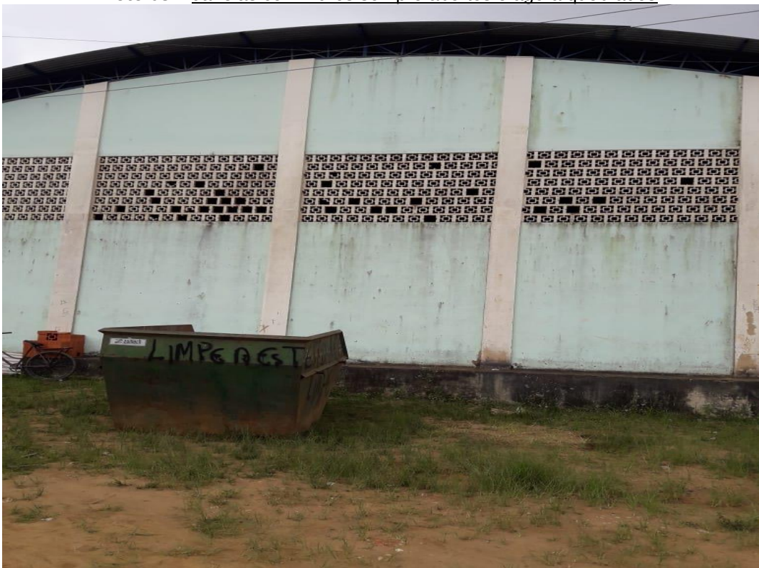
Foto 04 – Janelas com vários elementos vazados de concreto (comungol) quebrados
