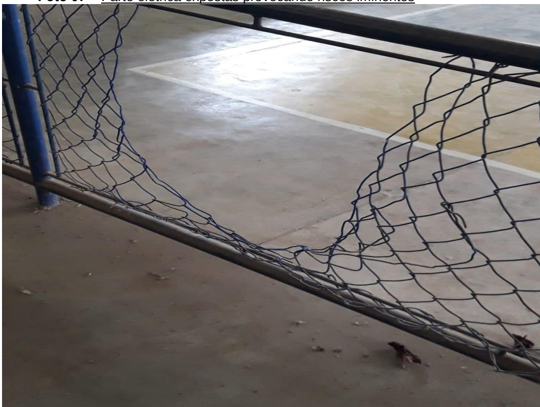
Foto 08 - Alambrado com nível avançado de deterioração
