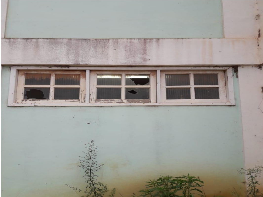
Foto 01 – Janelas com vidros quebrados
