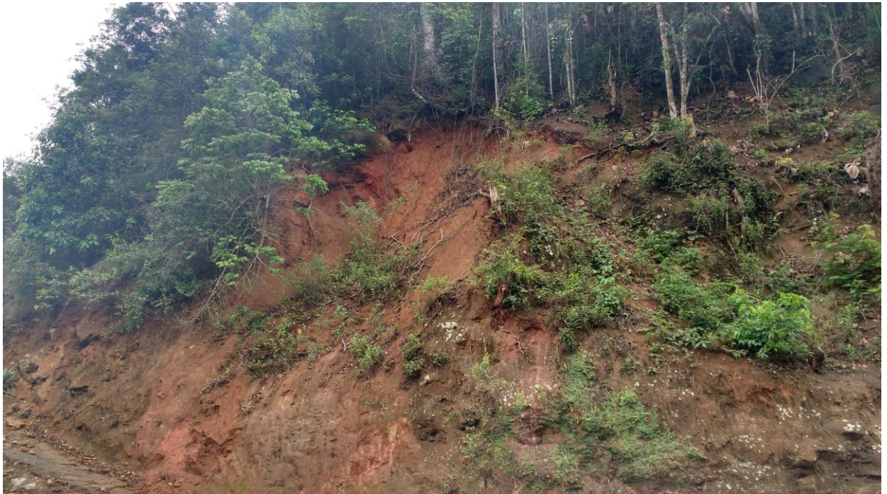
Foto 02 – Vista de pedras e raízes expostas, aumentando o risco de deslizamento
