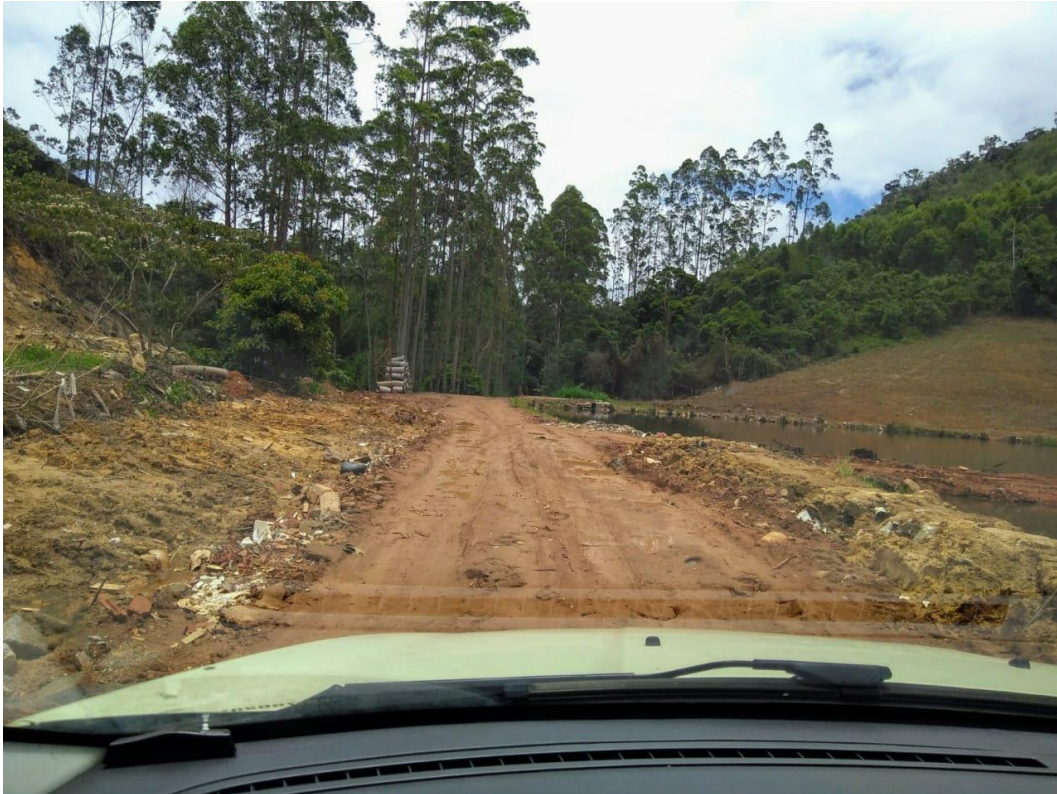
Foto 1 - Vista de um trecho da via vicinal em péssimas condições de tráfego
