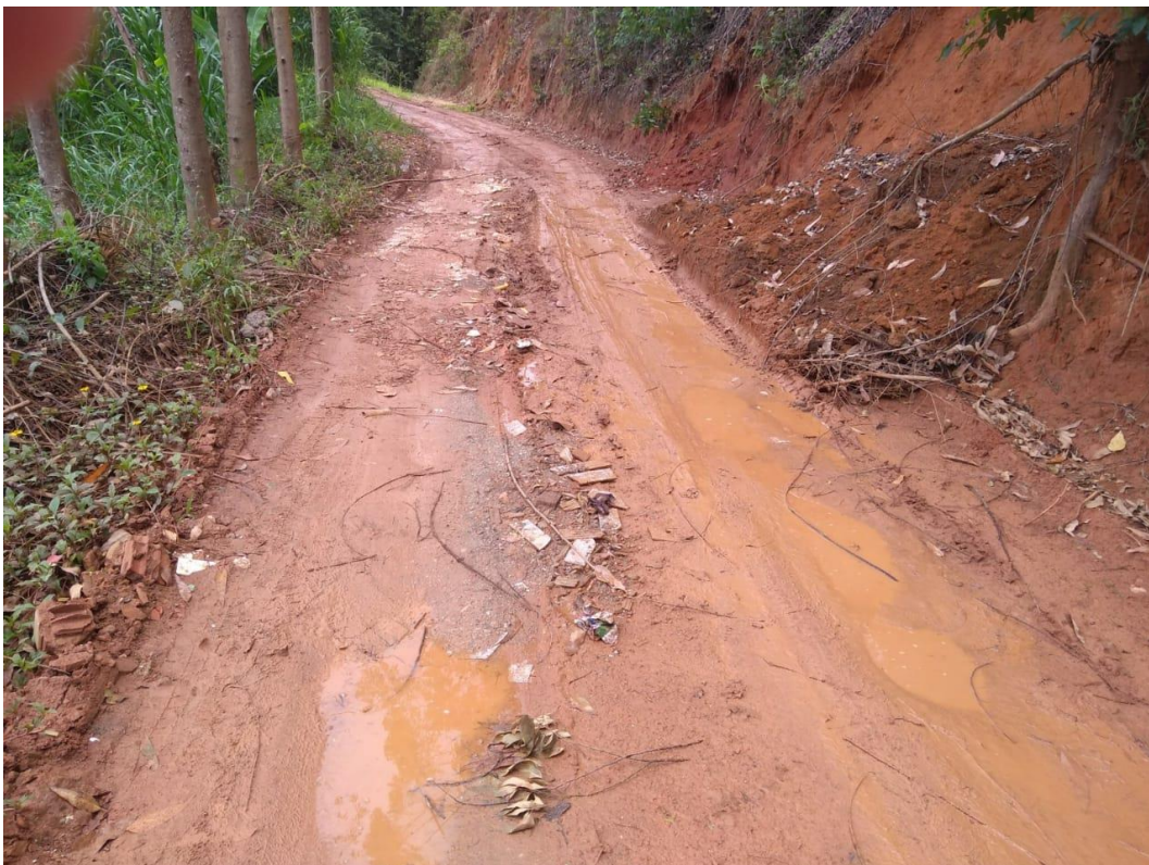
Foto 2 - Vista de outro trecho da via vicinal que necessita de intervenções
