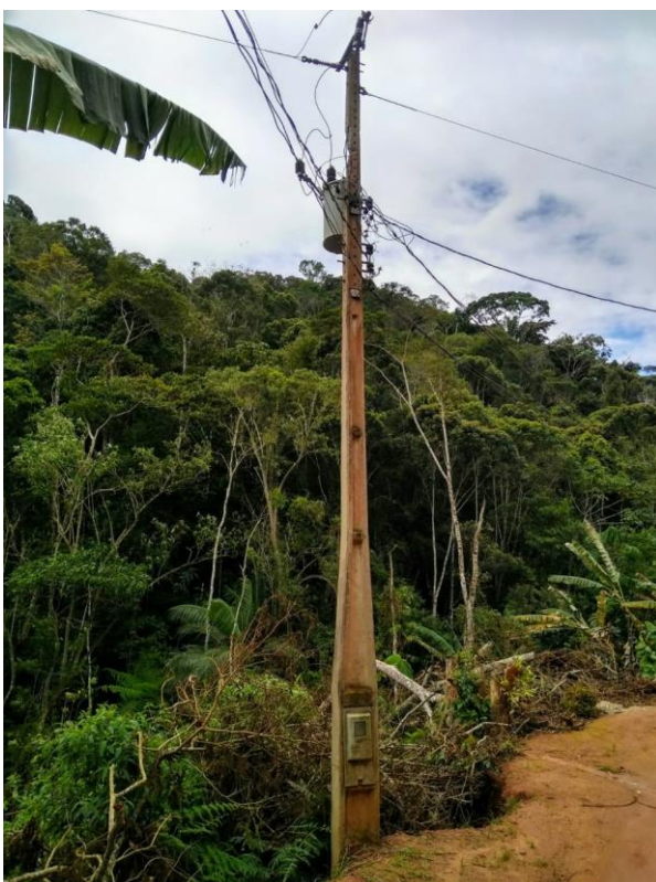
Foto 4 - Poste em risco de queda após as últimas chuvas
