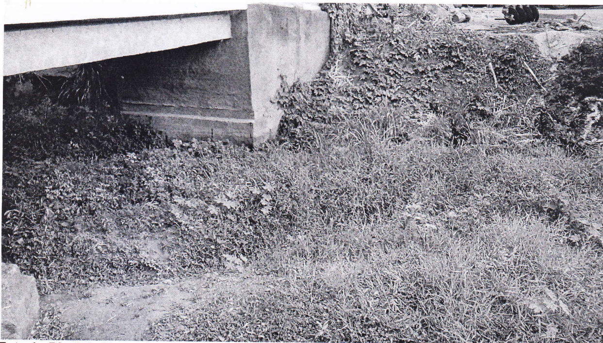
Foto 1 - Rio 5 de Novembro - presença de mato obstruindo a vazão do curso d'água
