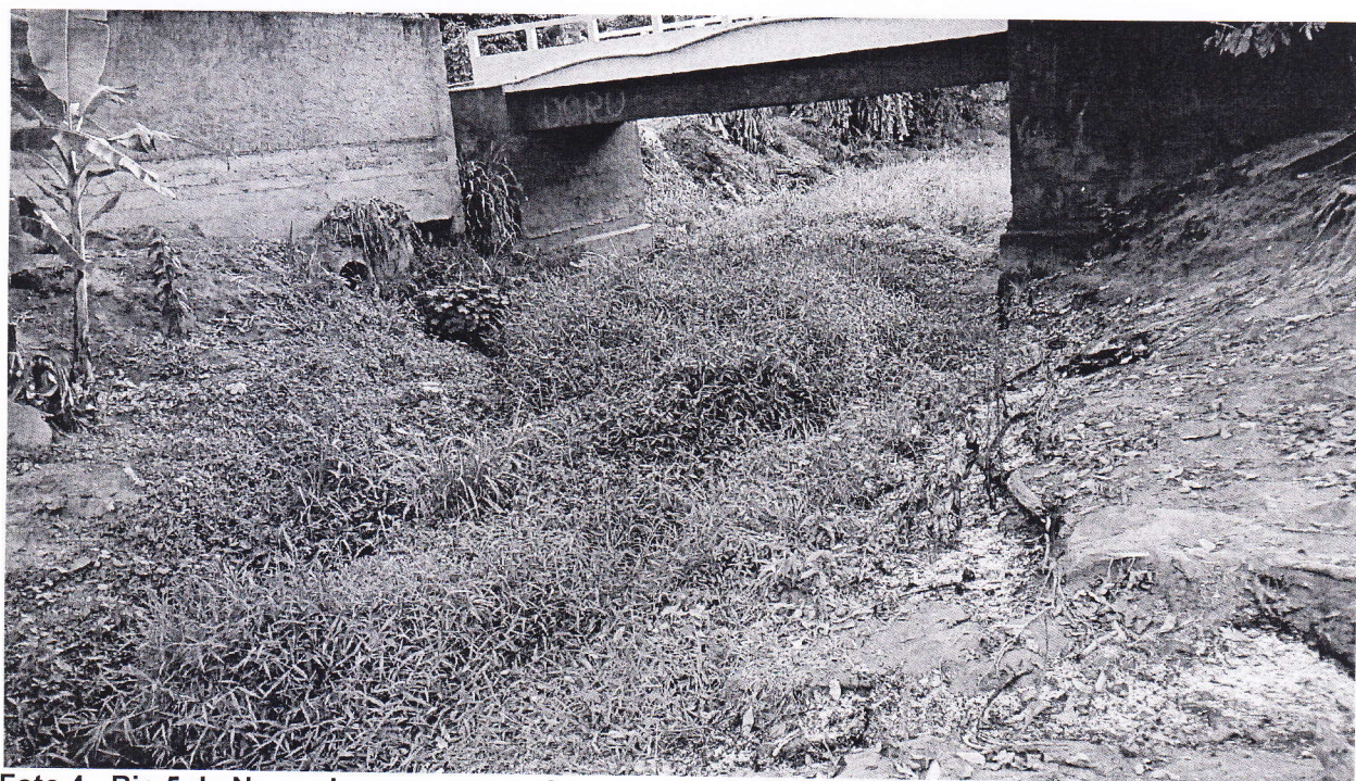
Foto 4 - Rio 5 de Novembro - presença de mato no leito, obstruindo a vazão
