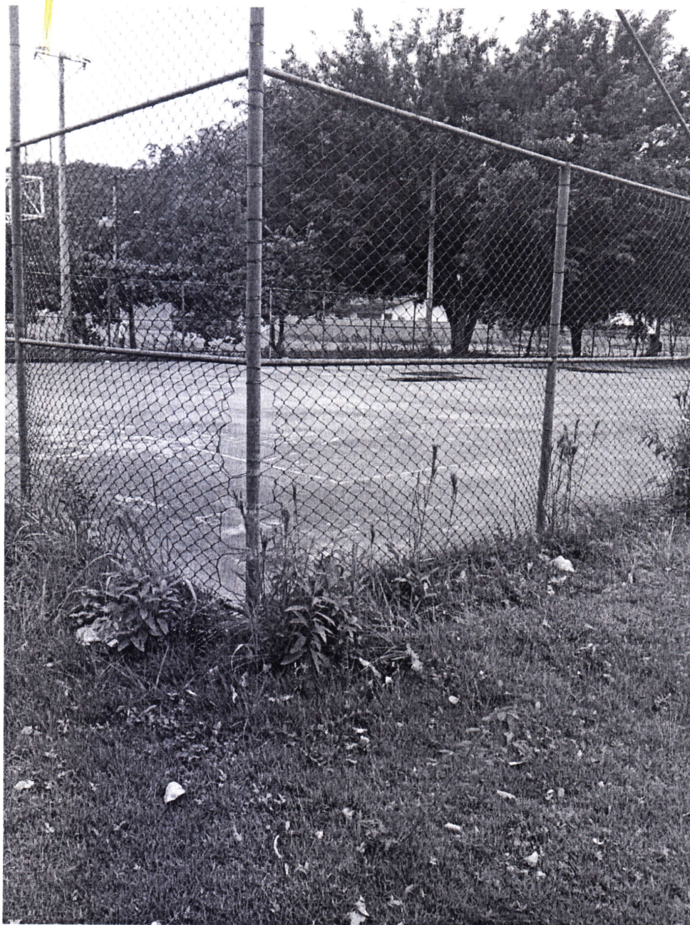
Foto 2 - vista do alambrado danificado, precisando de substituição
