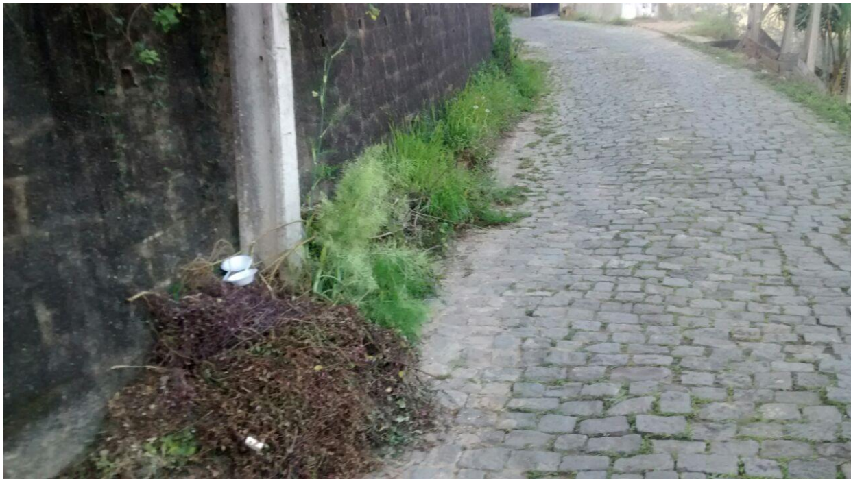
Foto 1 - Rua Niterói - acúmulo de mato por falta de manutenção.
