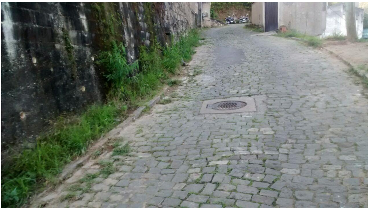
Foto 2 - Rua Niterói - necessidade de manutenção (capina, limpeza, etc.)
