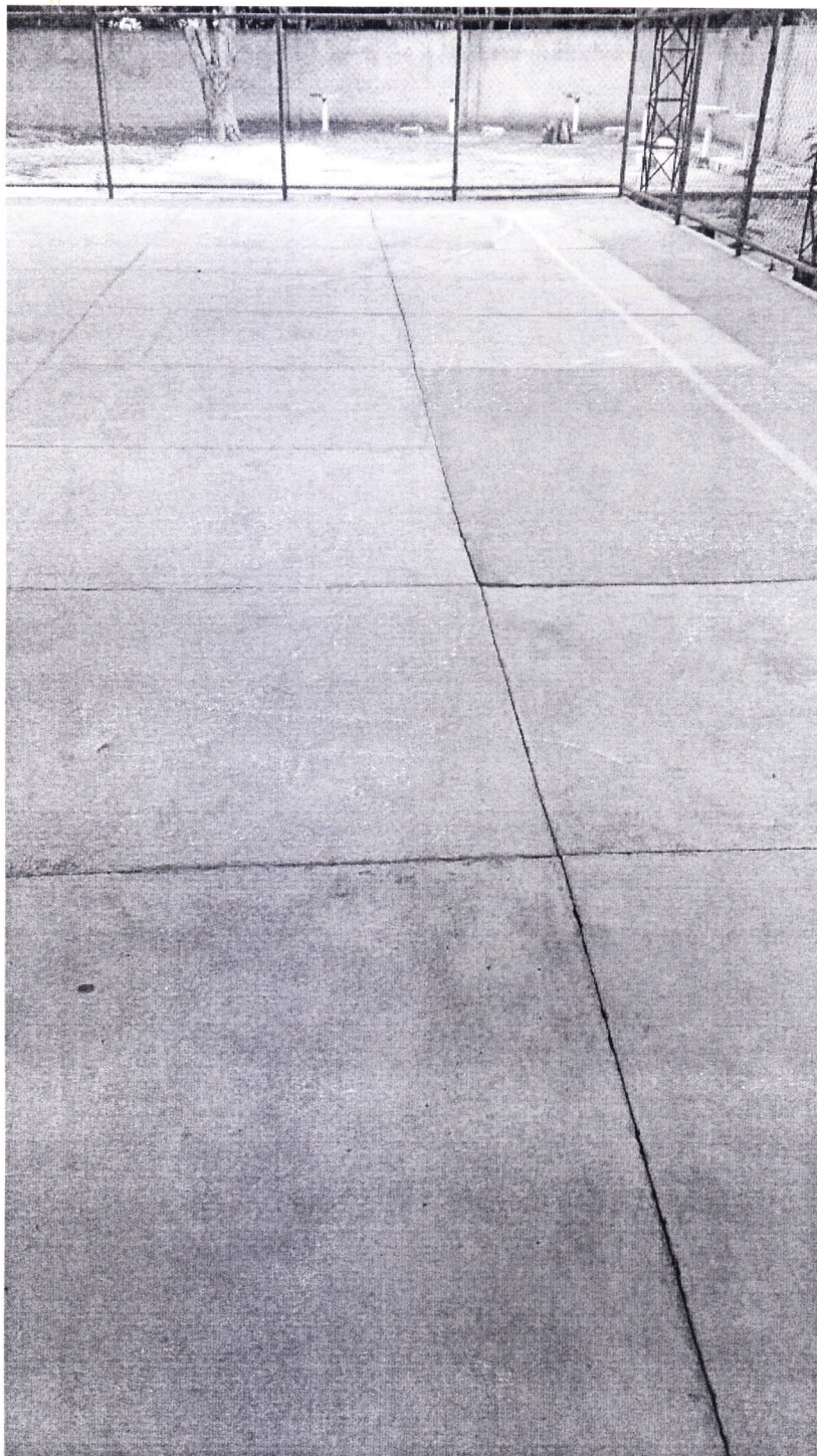
Foto 01 - Piso irregular, com ressaltos
