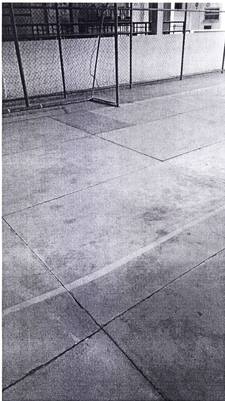
Foto 02 – Piso com ressaltos e alambrado danificado
