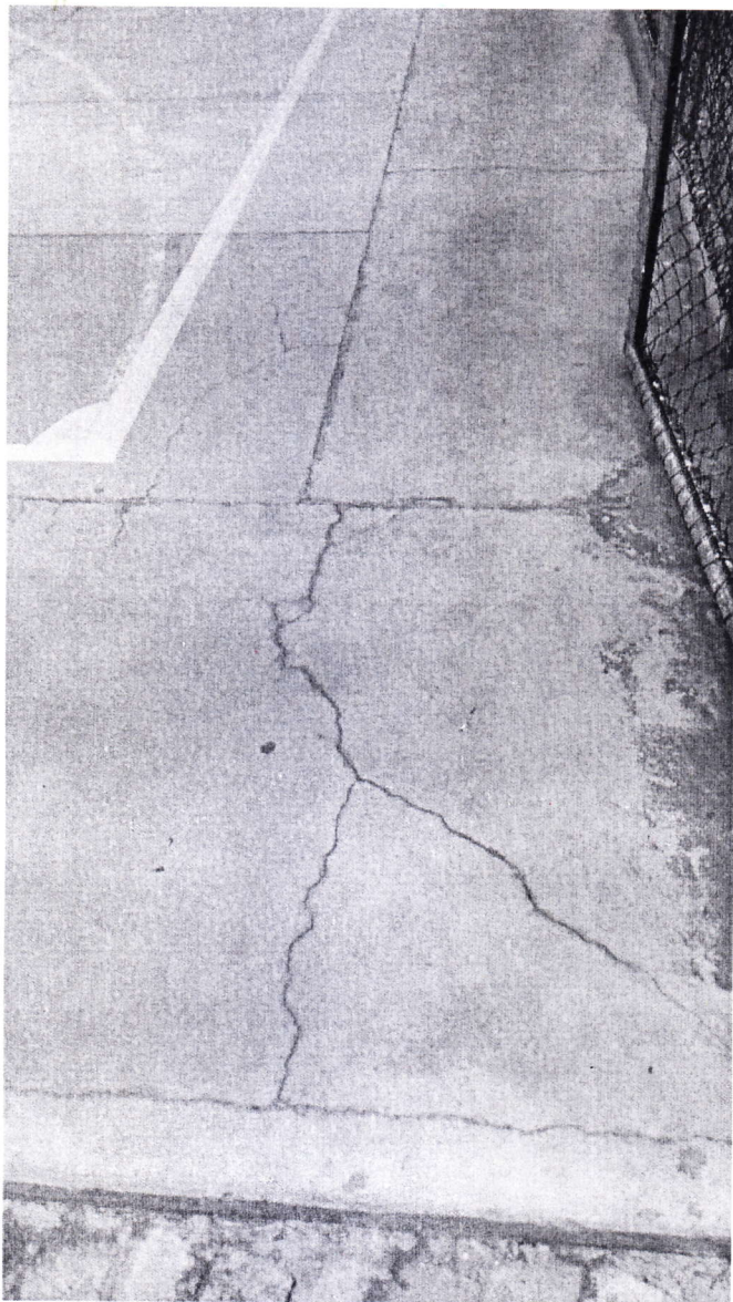
Foto 03 – Piso com rachaduras
