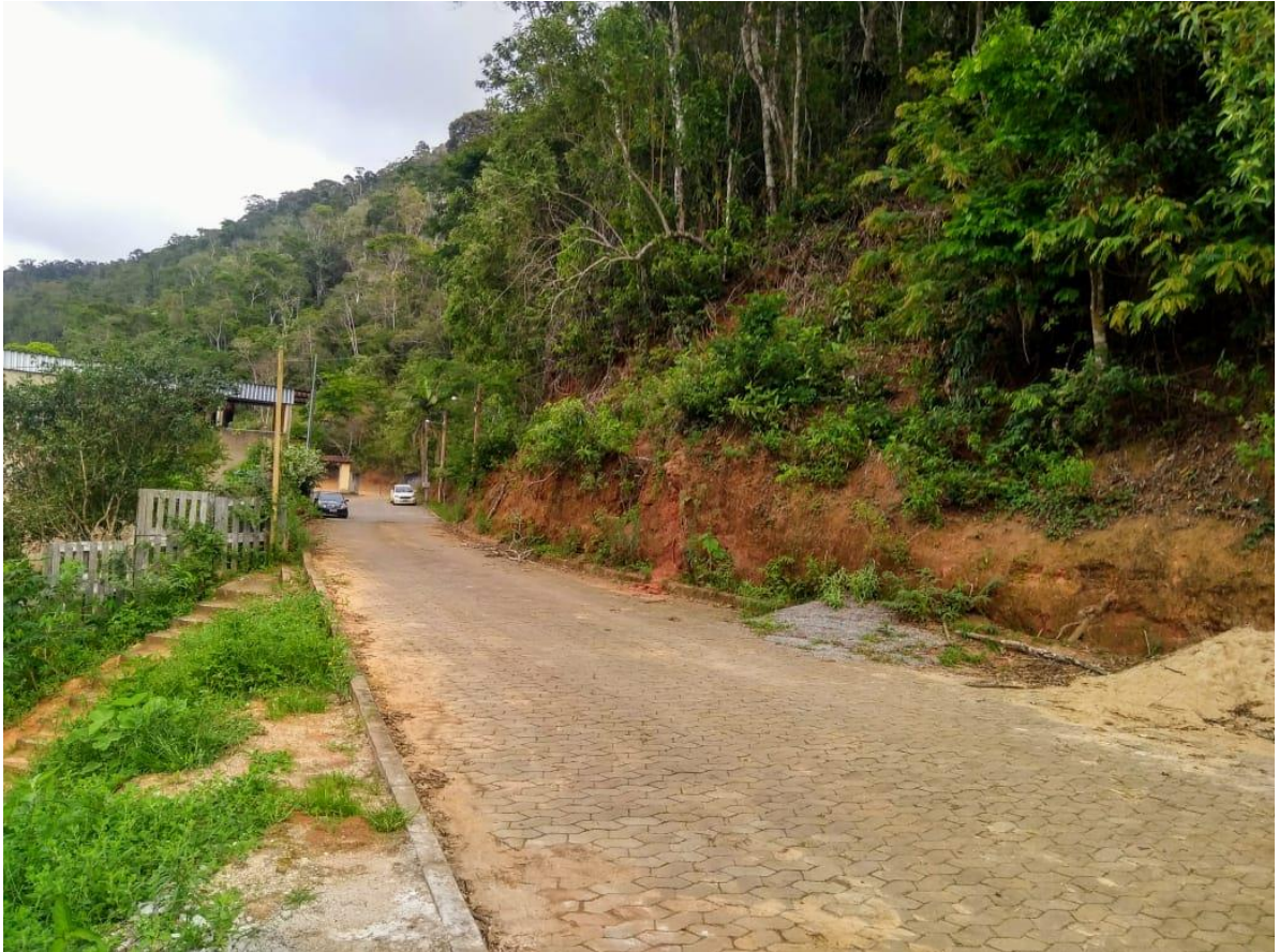
Foto 01 – final da rua Juliano Zamprogno, desprovida de iluminação pública
