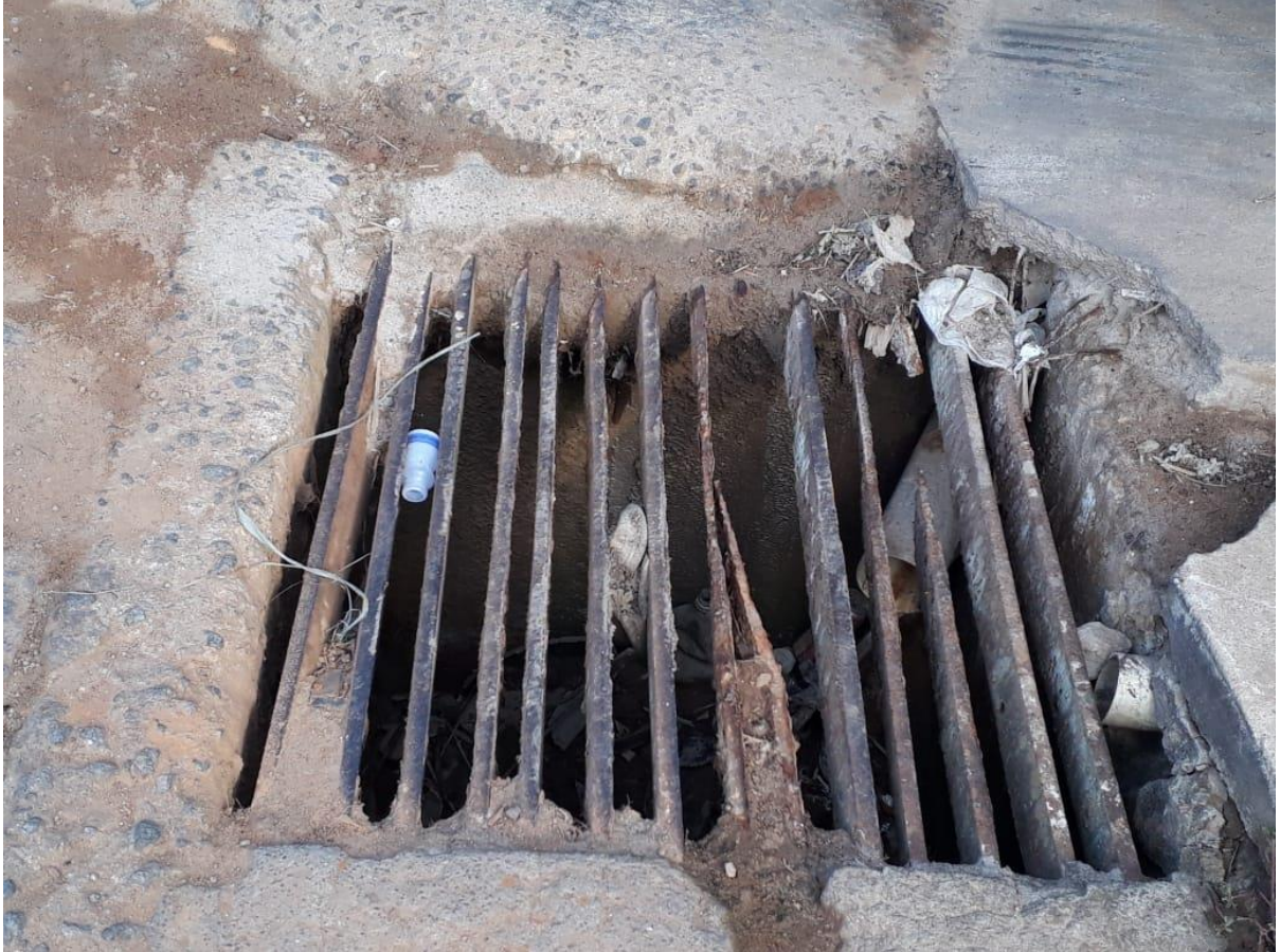
Foto 1 - vista da situação crítica em que se encontra a estrutura (risco de acidentes)
