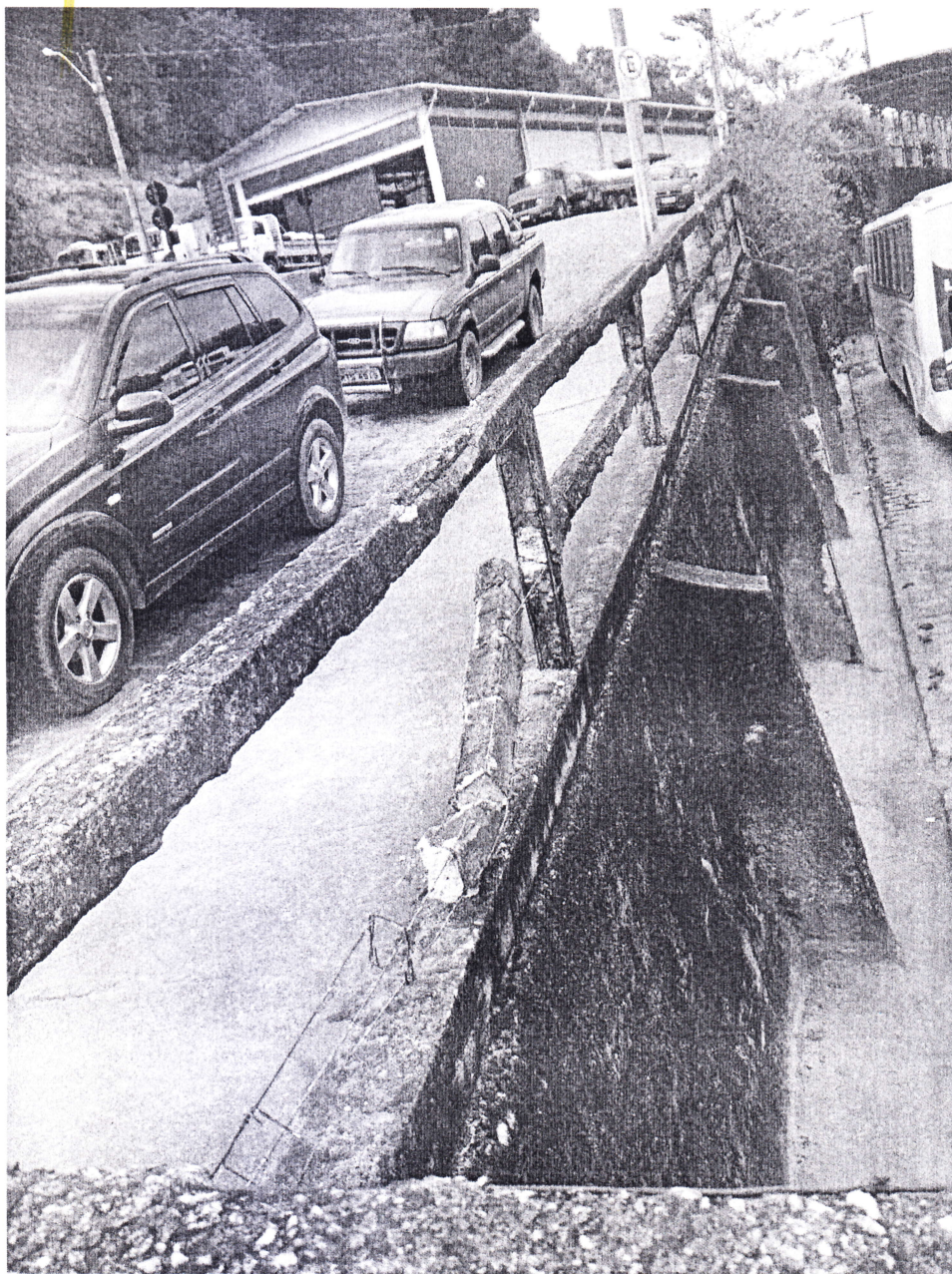
Foto 03 – A situação atual representa risco de acidentes (queda)
