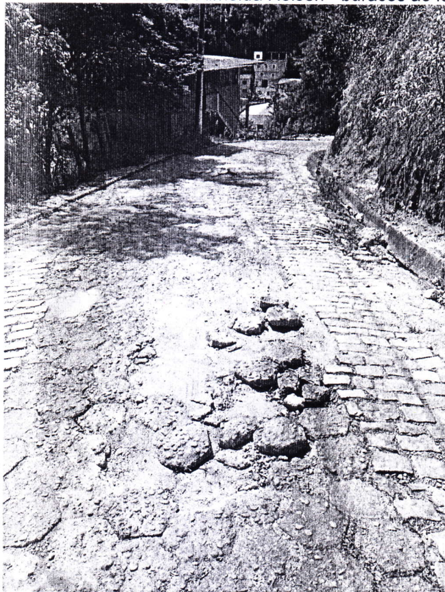
Foto 2 - Pavimentação irregular, bloquetes do pavimento desnivelados
