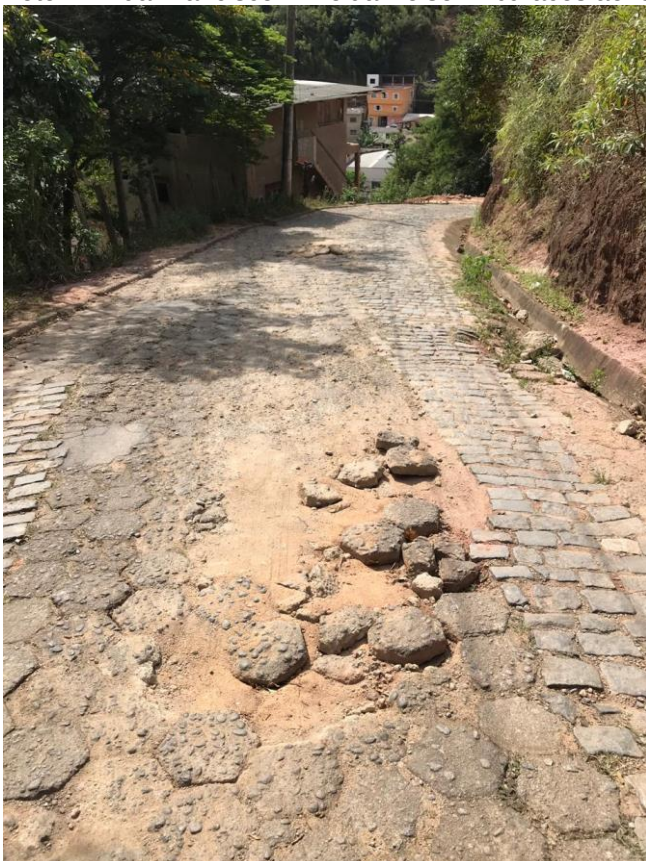
Foto 2 - Pavimentação irregular, bloquetes do pavimento desnivelados
