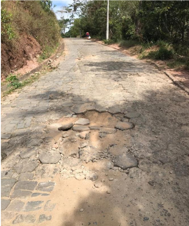
Foto 1 - Rua Francisco Almeida Reisen - buracos ao longo da via
