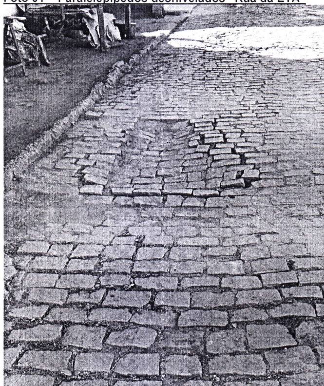
Foto 02 – Paralelepípedos desnivelados/surgimento de buraco “Rua da ETA”
