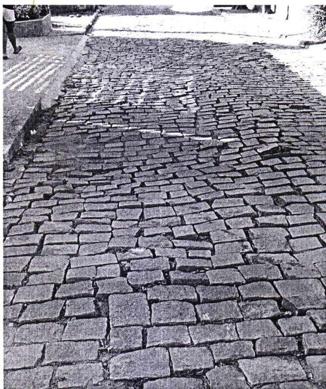
Foto 01 – Paralelepípedos desnivelados “Rua da ETA”
