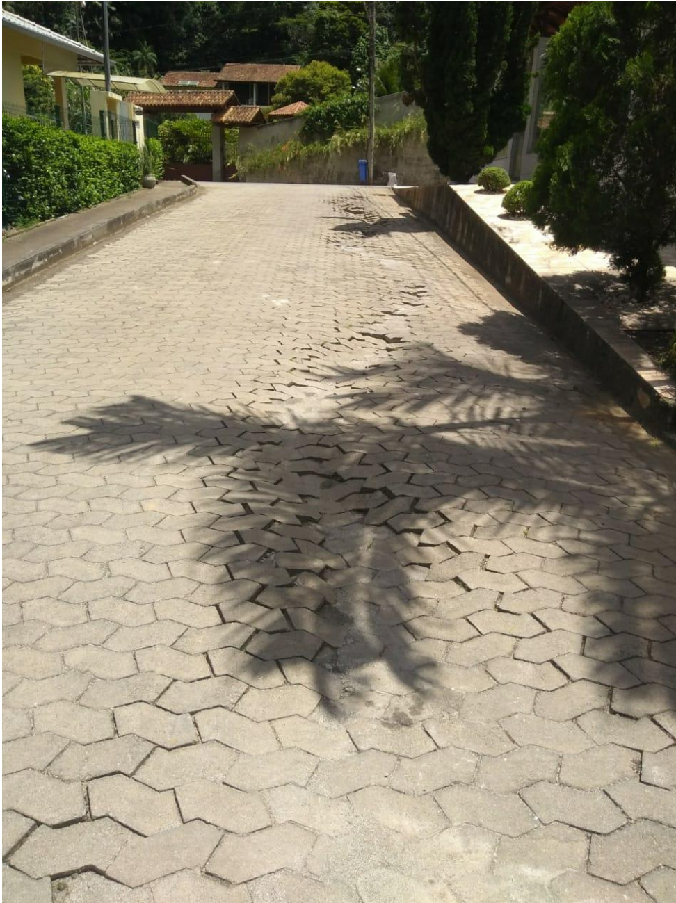
Foto 1 – vista do afundamento da rua Dário Severio Coser, no bairro Vila Nova
