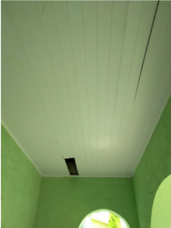
Foto 1 - forro necessitando de manutenção
