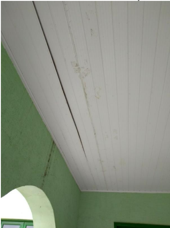
Foto 2 - neste local há infiltração e o forro está danificado
