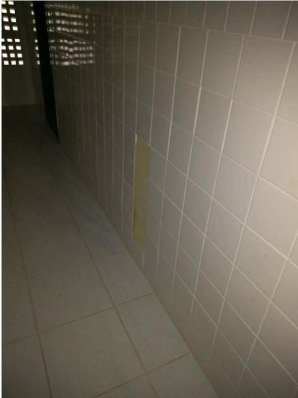
Foto 3 - Cerâmica faltando na parede
