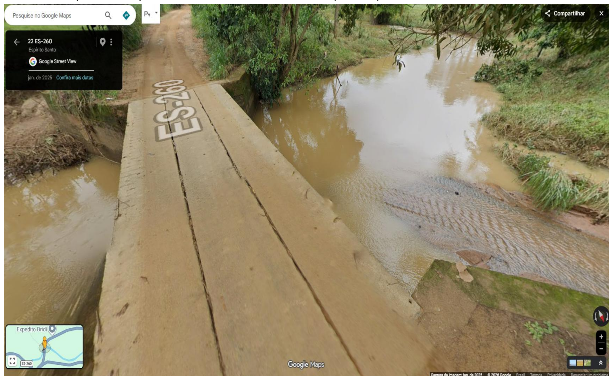
4. Condições estruturais precárias da ponte.
