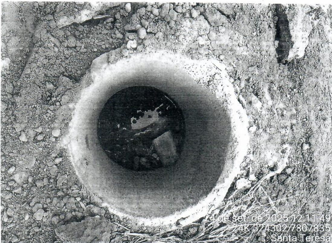
Obstrução da rede primária de esgoto
