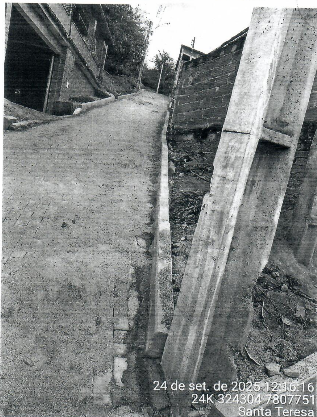
Desalinhamento do meio fio
