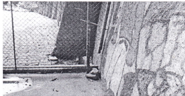
Foto 08 - Quadra poliesportiva com várias partes do alambrado deterioradas.
