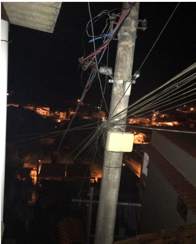
Foto 4 - luminária apagada na Escadaria Braz Vicente
