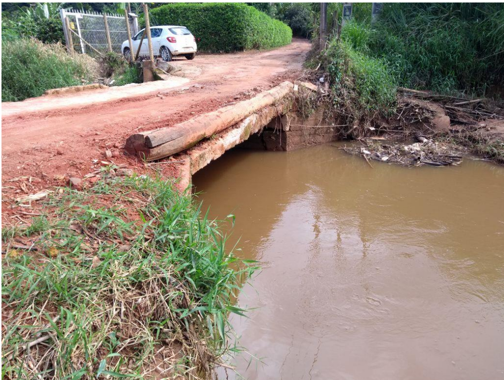
Foto 2 – Nota-se que a estrutura está muito próxima do rio
