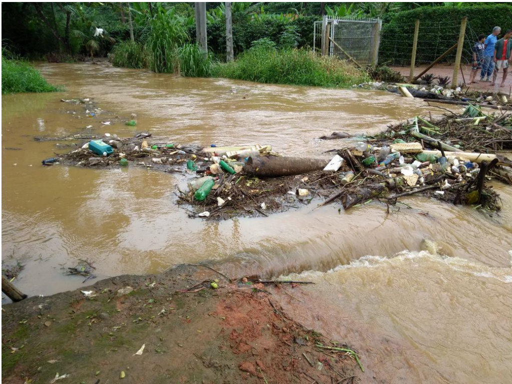
Foto 4 - vista do lixo carregado pelas águas e a ponte totalmente submersa
