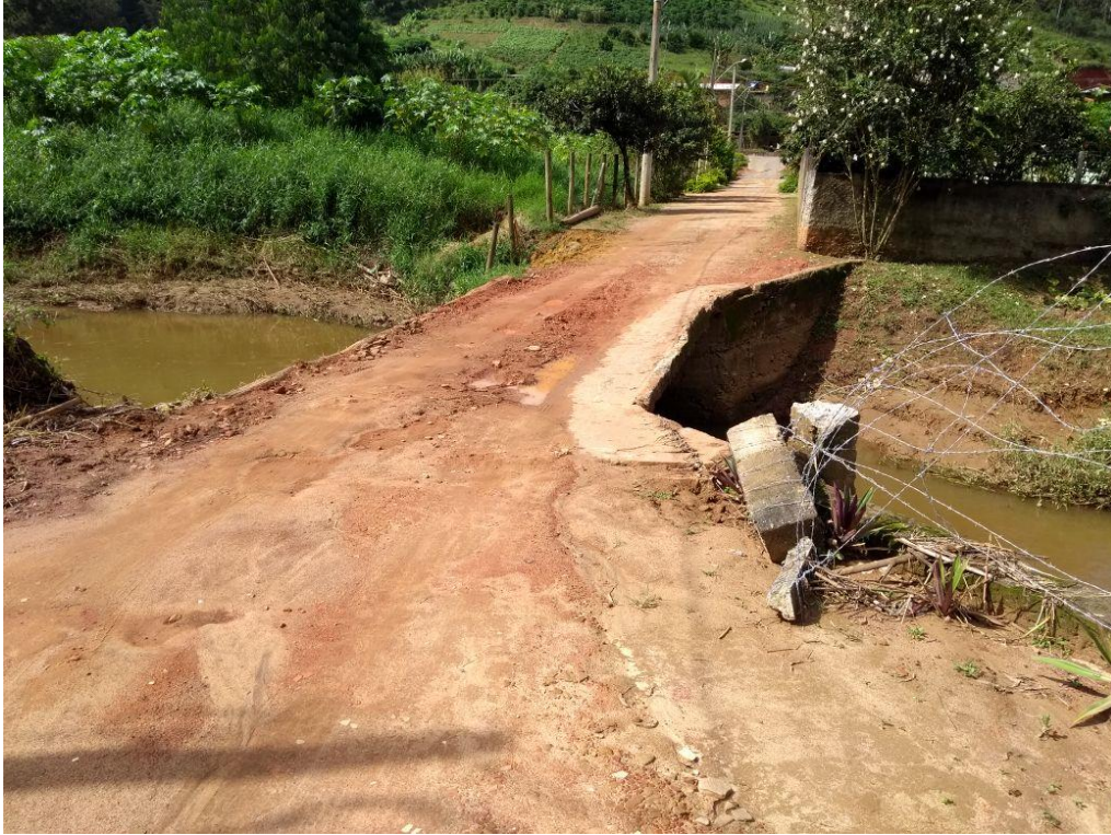
Foto 1 - vista da ponte em péssimas condições, sem guarda-corpo, danos estruturais
